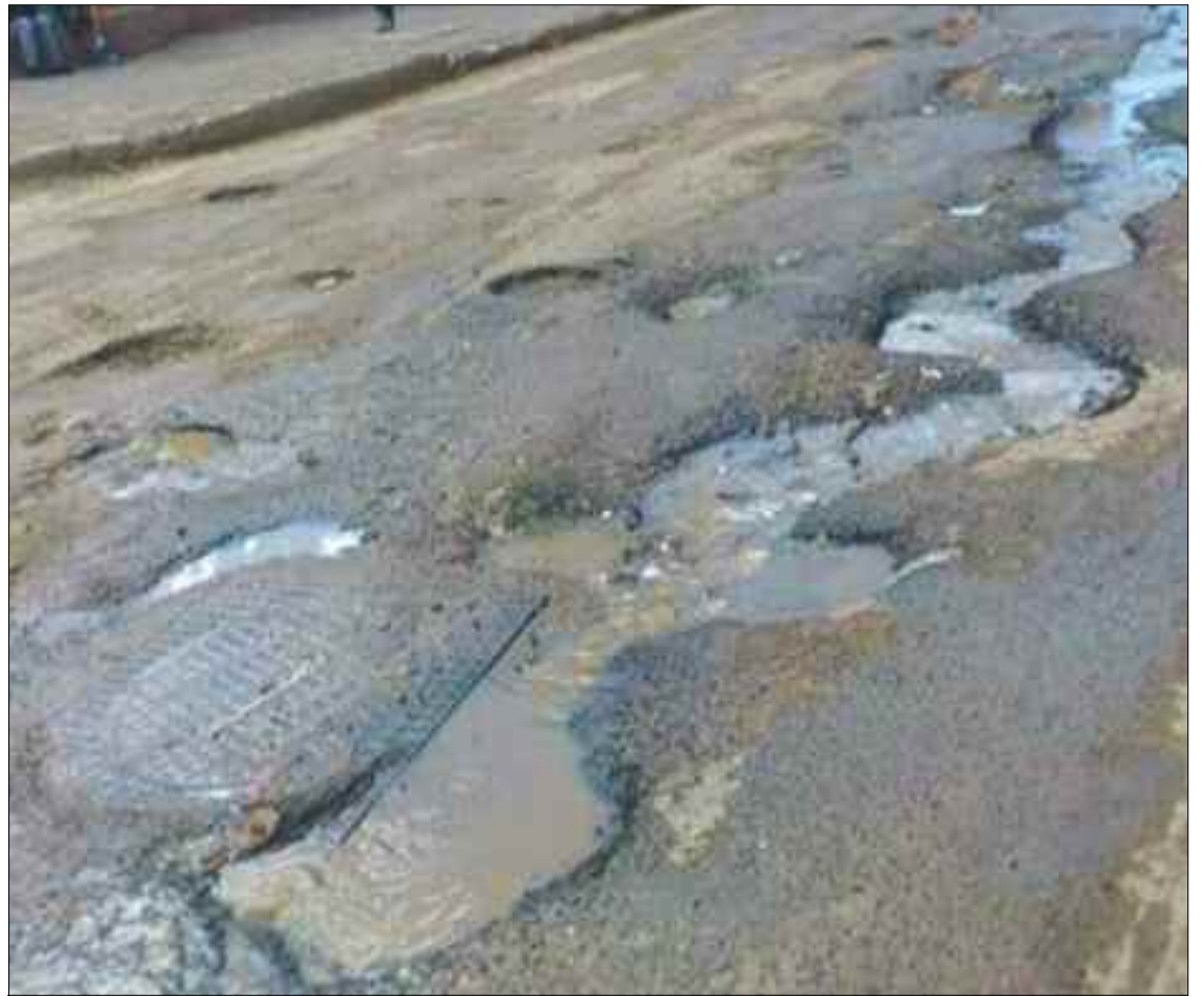
Le tronçon routier de la route des Martyrs s'est transformé en danger quotidien pour les conducteurs de véhicules légers et les centaines de poids lourds. (Photo > D. R.)
